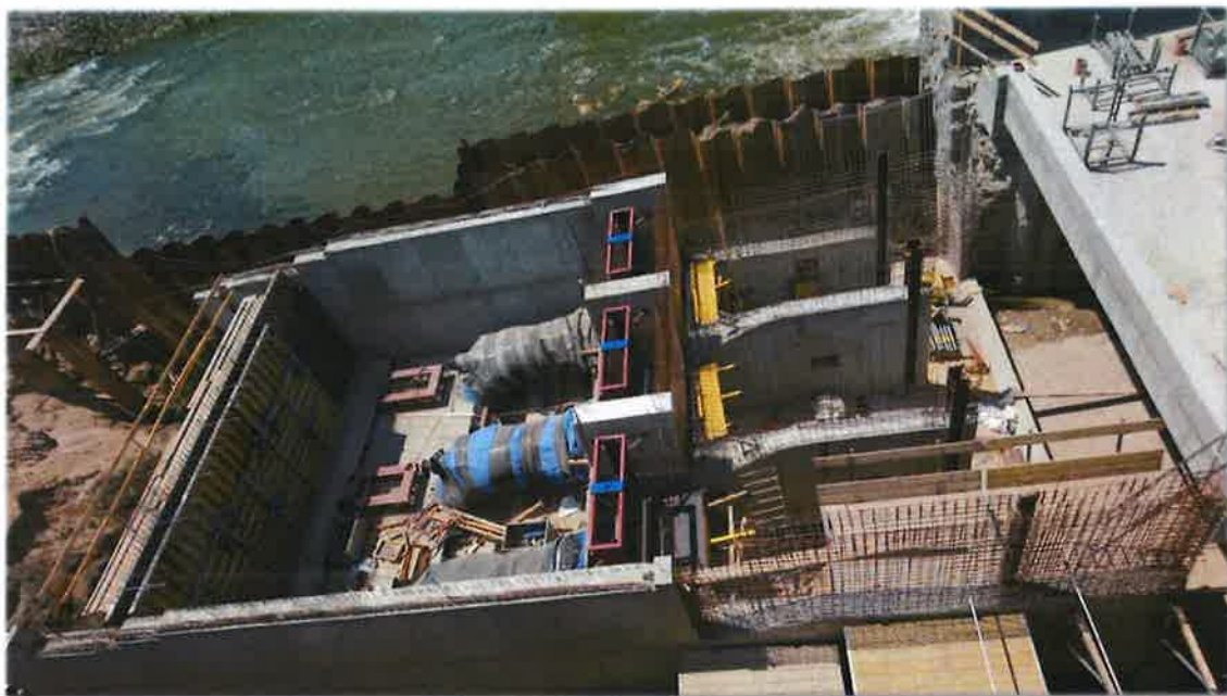
Malá vodná elektrárň Malé Krškany
