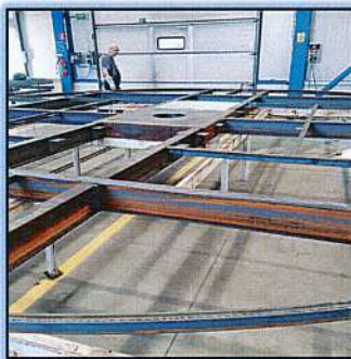
Konštrukcie na antény
