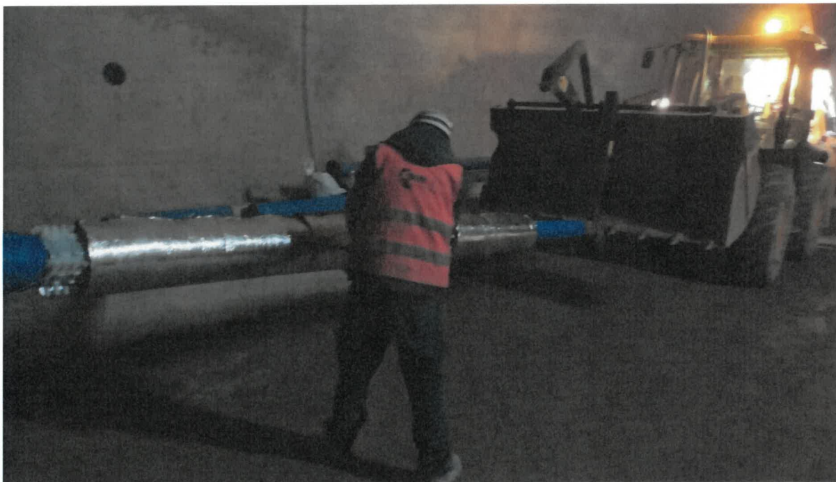
Obrázok 5 - Čebrať tunel - požiarny vodovod
