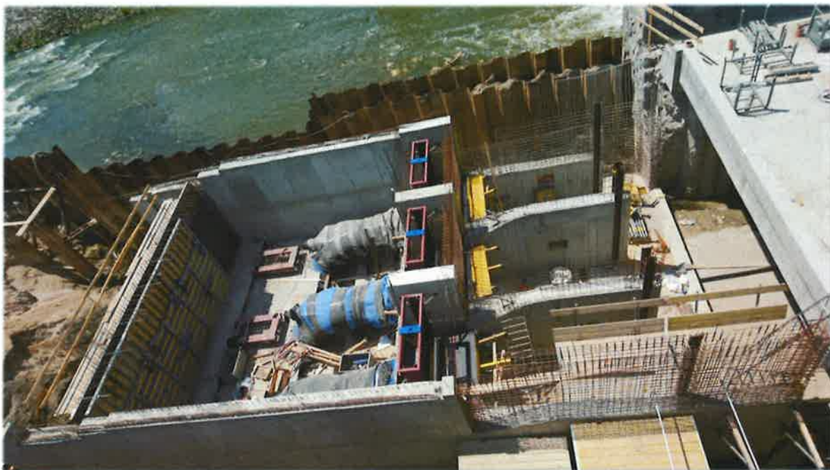
Malá vodná elektrárň Malé Krškany
