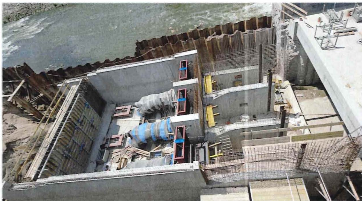
Malá vodná elektrárň Malé Krškany
