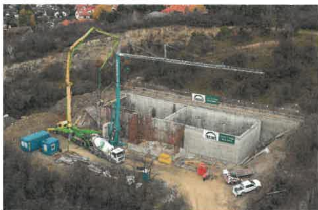
Záhorská Bystrica – vodojem, prívodné a zásobné potrubie
