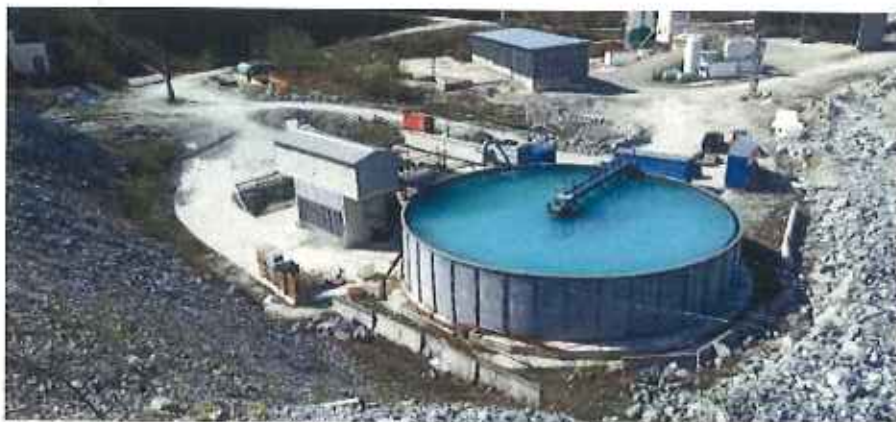
Mechanicko-chemická ČOV na východnom portáli tunela Višňové
