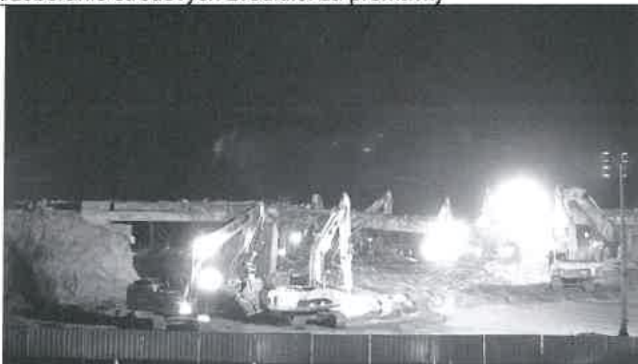
pád hlavného mostného poľa
