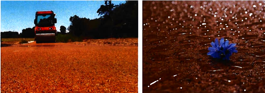
Obr. 12,13 - Rekonštrukcia a dobudovanie prístupových komunikácií, chodníkov v archeoparku Mikulčice - Kopčany na slovenskej strane k lávke cez rieku Moravu
