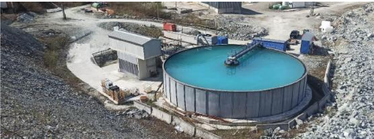
Mechanicko-chemická ČOV na východnom portáli tunela Višňové
